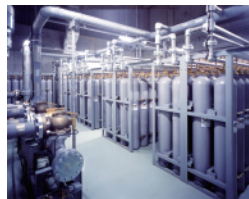
ガス消火設備
