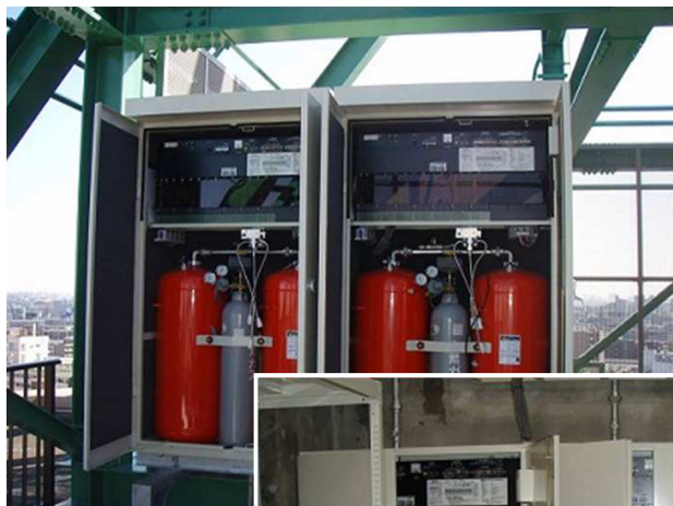
屋外型本体 の屋上設置例
